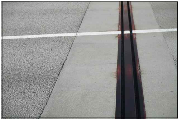
신축이음 후타재 균열(A1)
