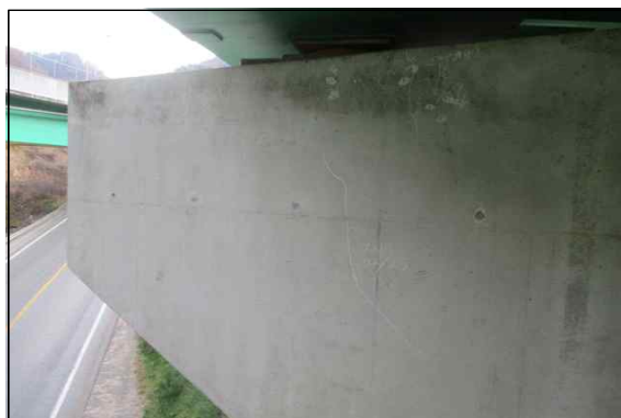
교각 코핑부 균열(P3)
