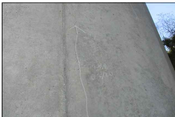
교각 기둥부 균열(P1)
